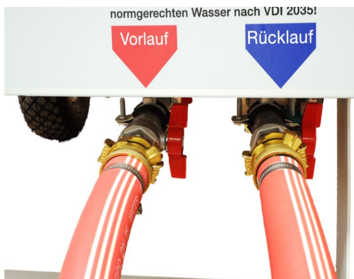
Abb. 8): Verbindungsschläuche DN25 am Heizungsvor- und -rücklauf der mobilen Elektroheizzentrale - Armaturen sind geschlossen -
